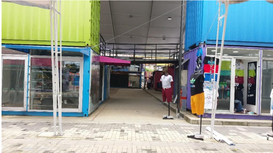
Se observa hundimiento y deformación del piso de adoquín instalado.
